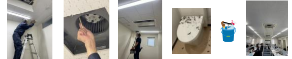
カバーを外し、ファンにこびりついたホコリを落とし、掃除機で最終仕上げ。思っていた以上にホコリがこびりついていました
